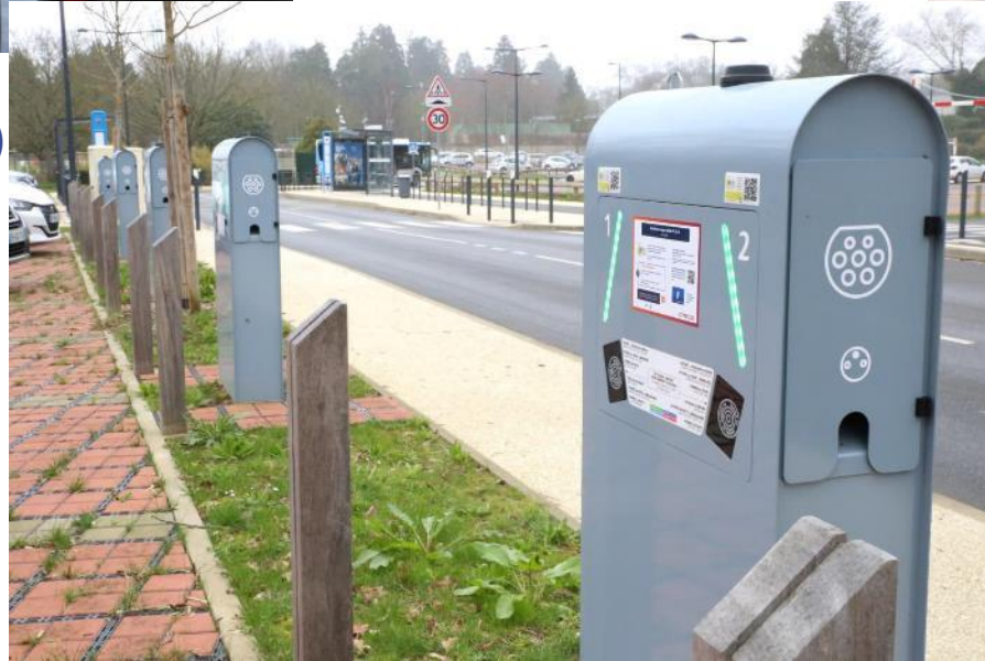
Bornes de recharge accélérée en voirie (22 kW courant alternatif triphasé)
